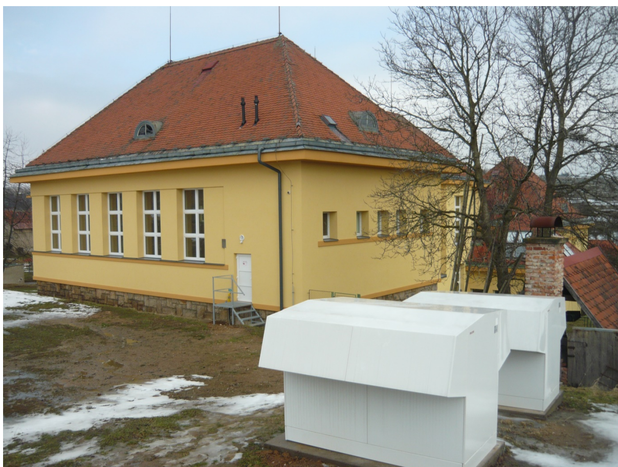
Obrázek 38 Instalace 2 TČ vzduch – voda STIEBEL ELTRON WPL pro ZŠ Dubenec
