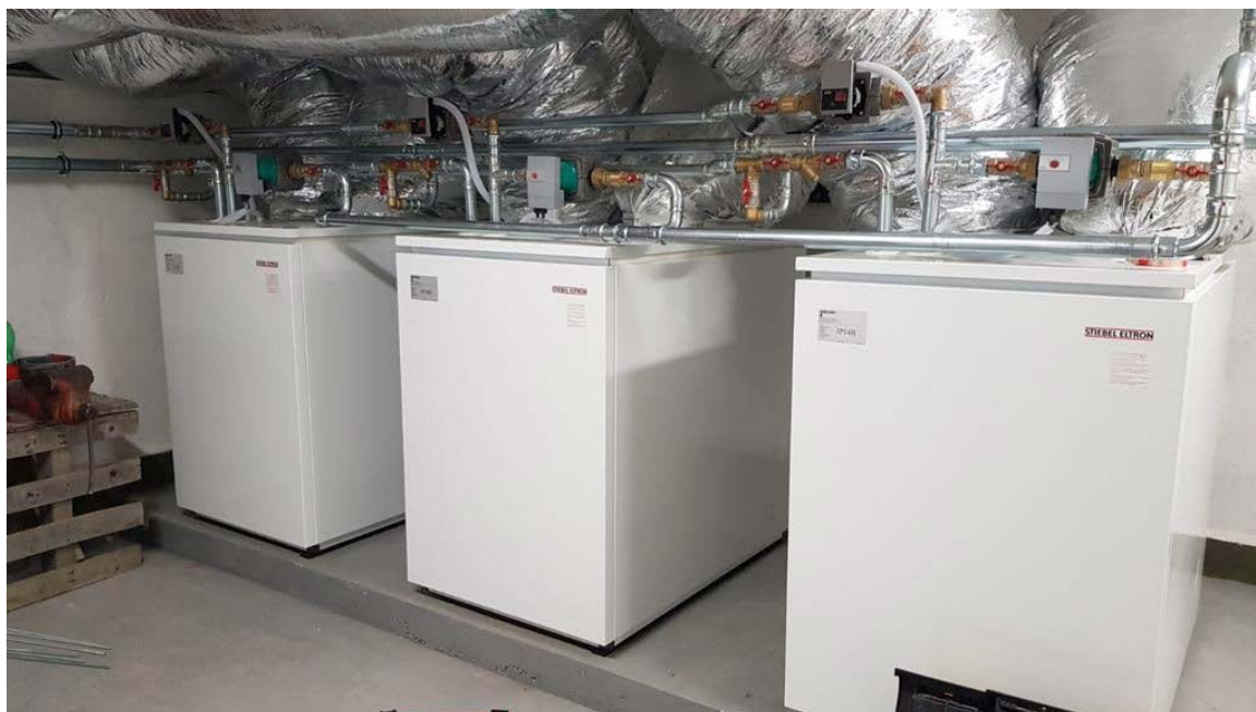
Obrázek 42 Pro změnu instalace 3 vnitřních TČ systému vzduch – voda pro vytápění a ohřev TUV kancelářského objektu
