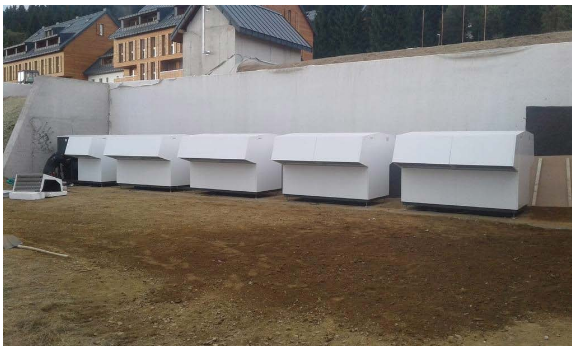
Obrázek 41 Venkovní instalace 6 TČ systému vzduch – voda pro horský obytný komplex, zapuštění pod terénem je voleno mj. z důvodu omezení šíření hluku při provozu TČ
