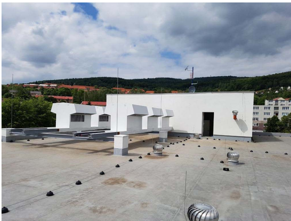
Obrázek 40 Střešní instalace kaskády 6 TČ vzduch – voda pro vytápění a ohřev TUV bytového domu
