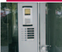
moderní dorozumivací zařízení u vstupu do domu
