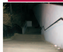
nedostatečné osvětlení na schodech
