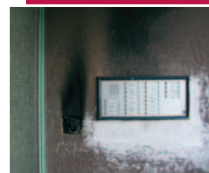
vandalismus na sídlišti vypálený vypínač
